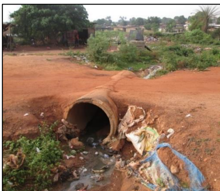
Figure 12 : Passage sous voie dégradé, à réhabiliter
