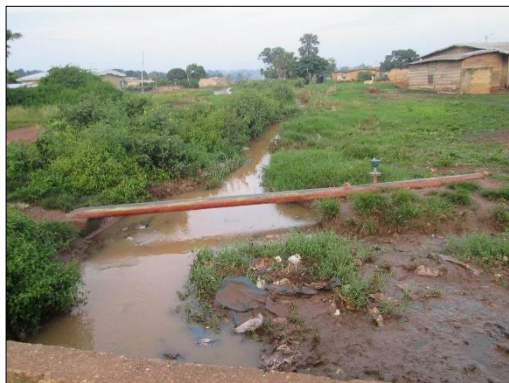
Figure 15 : Canal totalement ensablé
