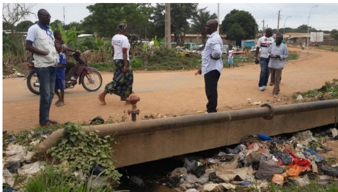
Figure 11 : Dalot ensablé à curer
