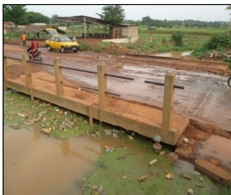
Figure 13 : Passage sous voie obstrué
