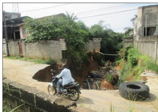
Figure 02 : Rupture de la voie d'accès
