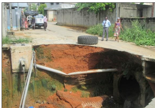
Figure 01 : Rupture de la buse métallique
