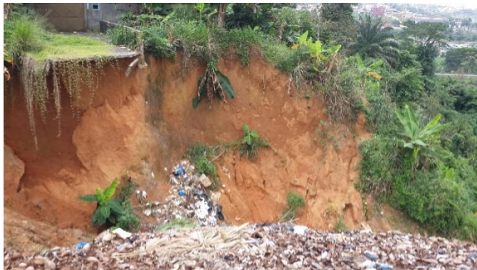
Figure 04 : Effondrement du talus et rupture de la voie annexe du Sanctuaire Marial
