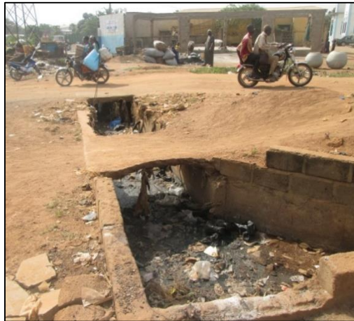
Figure 06 : Dalot dégradé à réhabiliter
