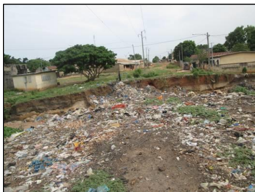
Figure 09 : Rupture de la voie de liaison entre les quartiers Bakayoko 1 et 2
