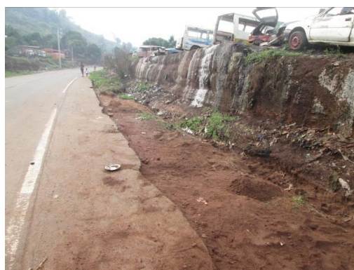
Figure 10 : Erosion des accotements par absence de caniveaux
