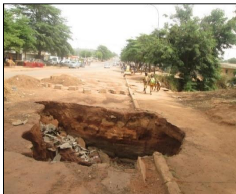
Figure 05 : Eboulement et rupture partielle de voie suite à l'effondrement d'un ouvrage de drainage
